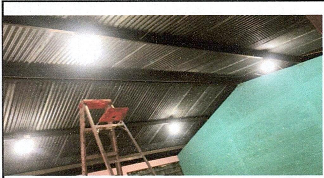
Foto 1: INSTALACION DE ENERGIA EN AULAS TERMINADA
